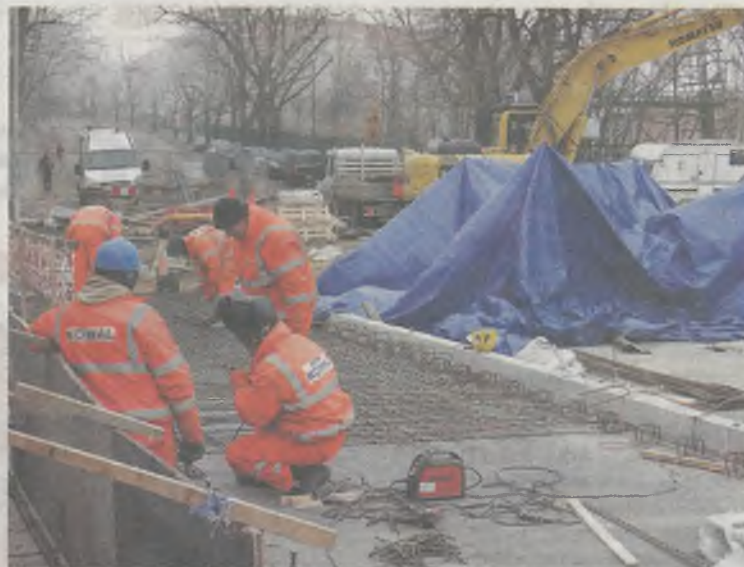
Remont konstrukcji wiaduktu przewidziany był na pięć miesięcy, a trwa już ósmy miesiąc.
