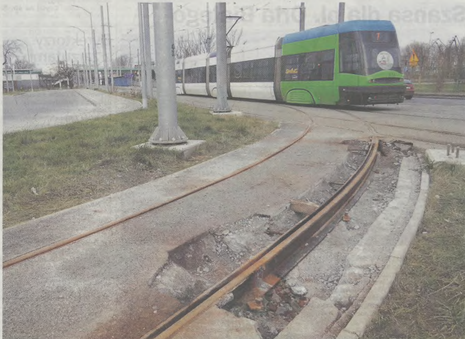
Nowe torowiska na ul. Gdańskiej i ul. Energetyków w Szczecinie. Odcinki, które pękały zimą 2016 r., wciąż są w wielu miejscach w różnych etapach napraw.
